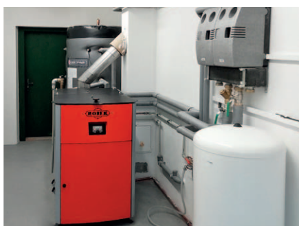
Vzorová kotelna s kotlem ROJEK PK BIO 40
