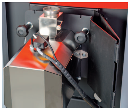
Uložení hořáku na kotli
