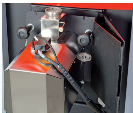
Uložení hořáku na kotli
